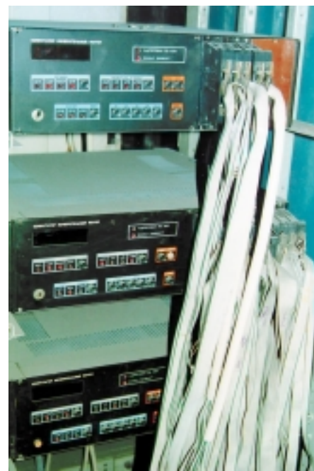
Рис. 4. Шкаф аналоговых коммутаторов Ф2111
