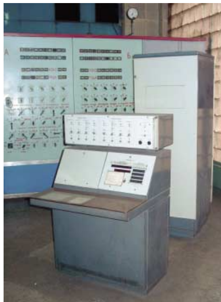
Рис. 4. Пульт управления системой, вмонтированной на доменной печи № 2 ОАО «Испат-Кармет»
