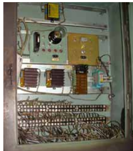
Рис. 2. Внешний вид блока местного управления (БМУ)
