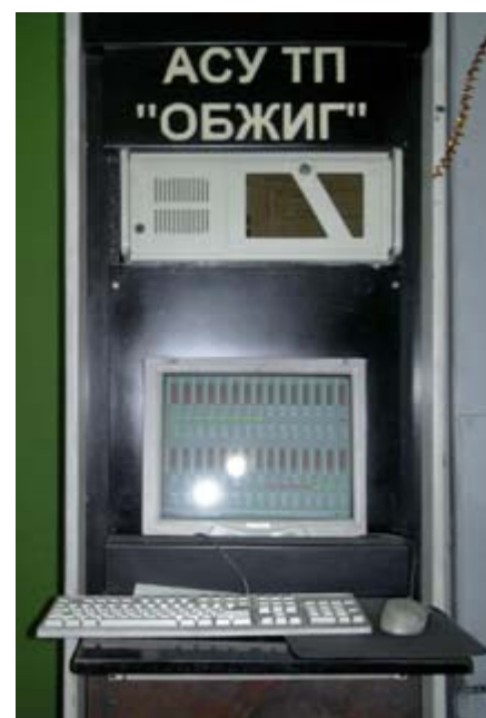
Рис. 4. Стойка управления обжиговой печи
