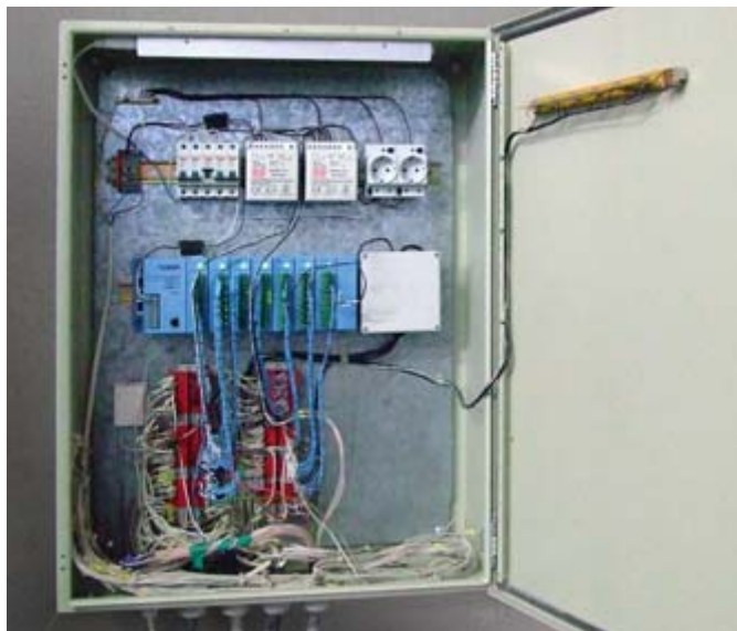
Рис. 6. Шкаф системы управления
