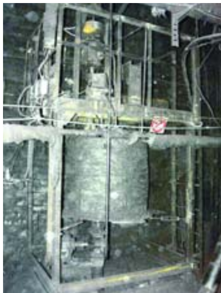
Рис. 1. Общий вид реконструированного дозировочного модуля
