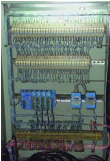
Рис. 5. Общий вид шкафа контроллера смесильной машины
