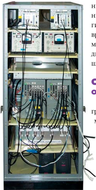
Рис. 2. Приборная стойка с оборудованием измерительного комплекса
