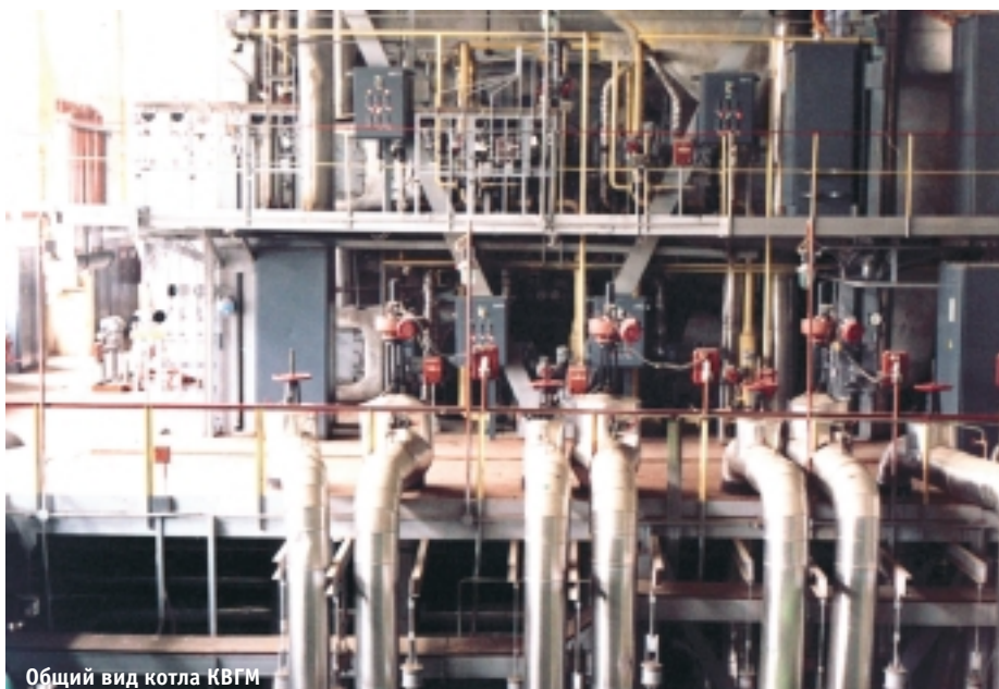
Общий вид котла КВГМ
