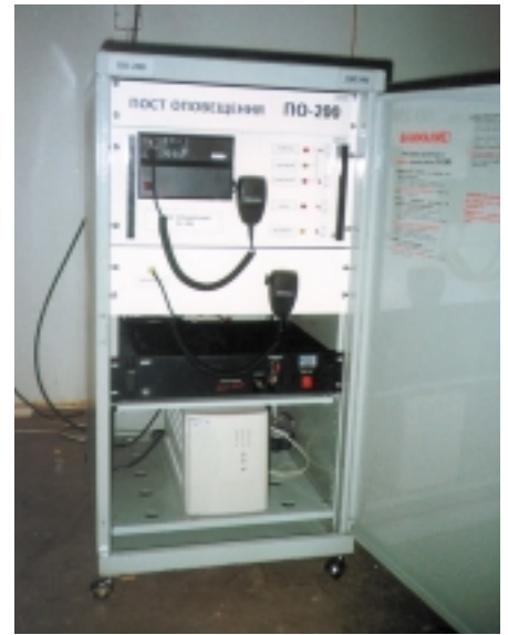
Рис. 2. Системный блок поста оповещения с открытой дверцей
