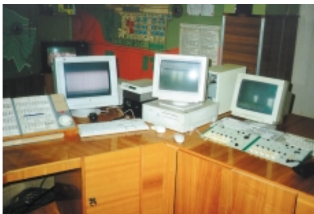
Рис. 7. Центральный пульт оповещения
