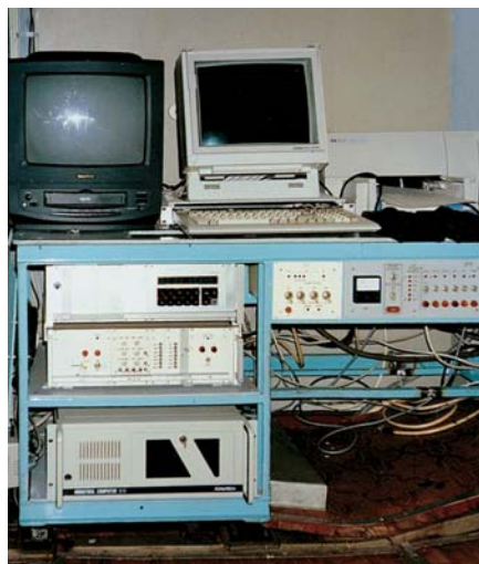
Рис. 1. Оборудование центрального поста
