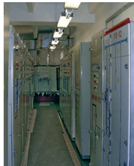
Рис. 2. Автоматы ввода резерва и распределители нагрузки
