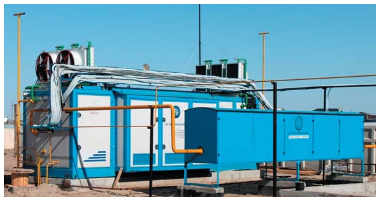
РИС. 8. ► Компрессорная станция, входящая в состав АГНКС
